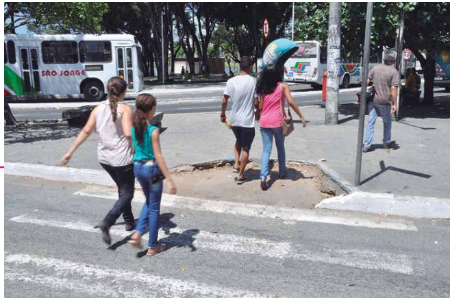
Pessoas que não têm problemas de locomoção também sofrem com os pisos irregulares e buracos nas calçadas
